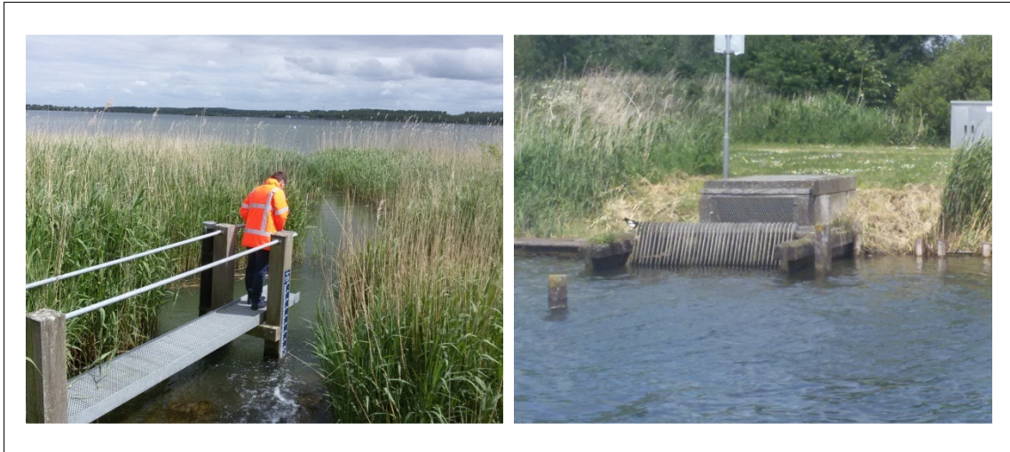
Afbeelding 5.1. Inlaat bij de hevel over de Markermeerdijk (links) en uitlaat richting het Hollandse hout
