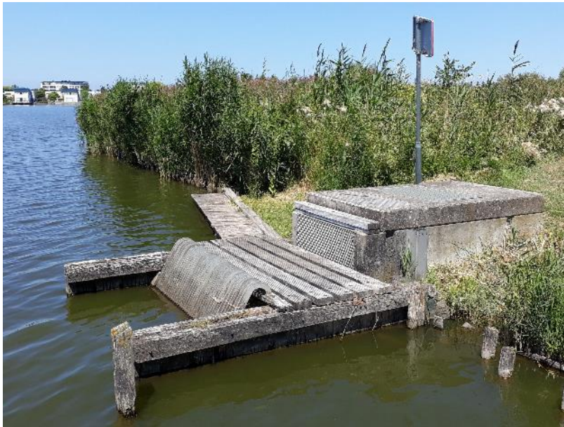
Afbeelding III.16 Stuw tussen 't Bovenwater en het Hollandse Hout
