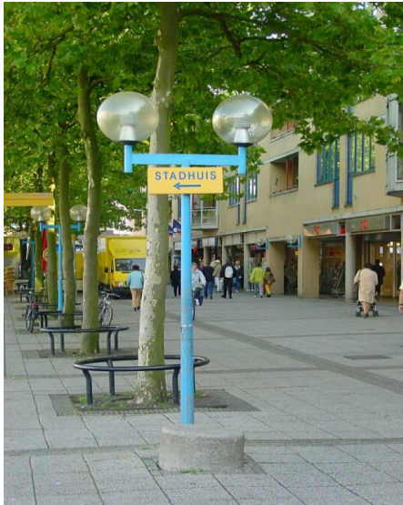
bolarmaturen met SON lamp (foto 19)
