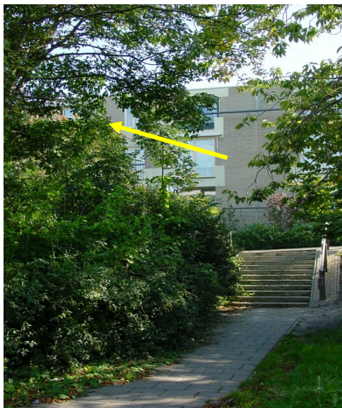
armatuur in boom bij trap Rode Klif (foto 11)
