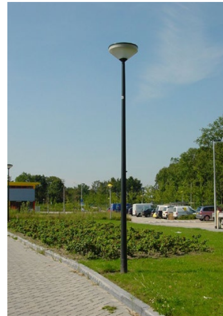
Rechts: lichtmast met uithouder aan de Zilverschoonlaan. Onder: verlichting woonstraten. Daarnaast: verlichting hoofdfietsroutes.
